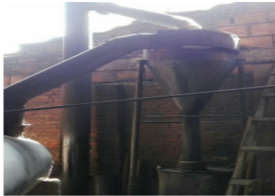
FOTO 3. SISTEMA DE CONTROL CALDERA DE 20 BHP
