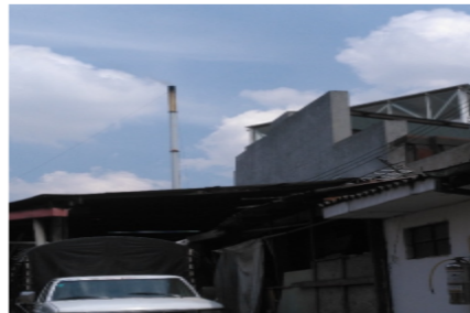
FOTO 4. DUCTO CALDERA DE 20 BHP
