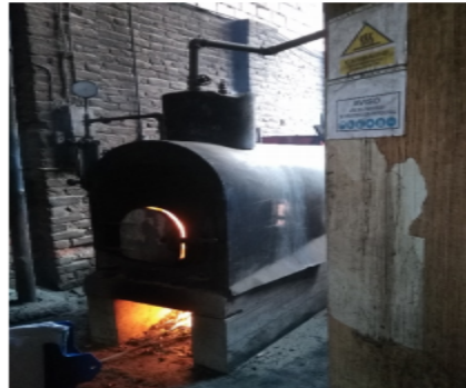
FOTO 2. CALDERA DE 20 BHP
